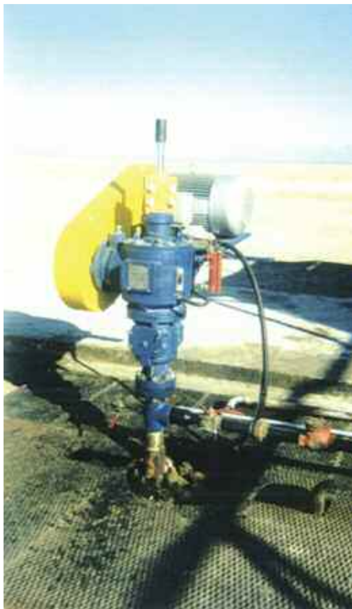
Figura 6: Boca de pozo LL-1003 con bomba PCP.
